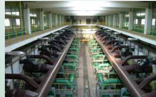
Überwachung Trinkwasseraufbereitung Polen, Fa. Iproplan
