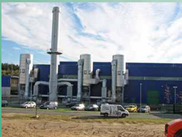
Abgasfilteranlage, Fa. LTC
