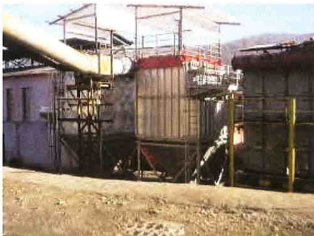
Modernizarea sistemelor de filtrare
